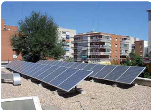
Primer fotovoltaičnih modulov na strehi objekta
